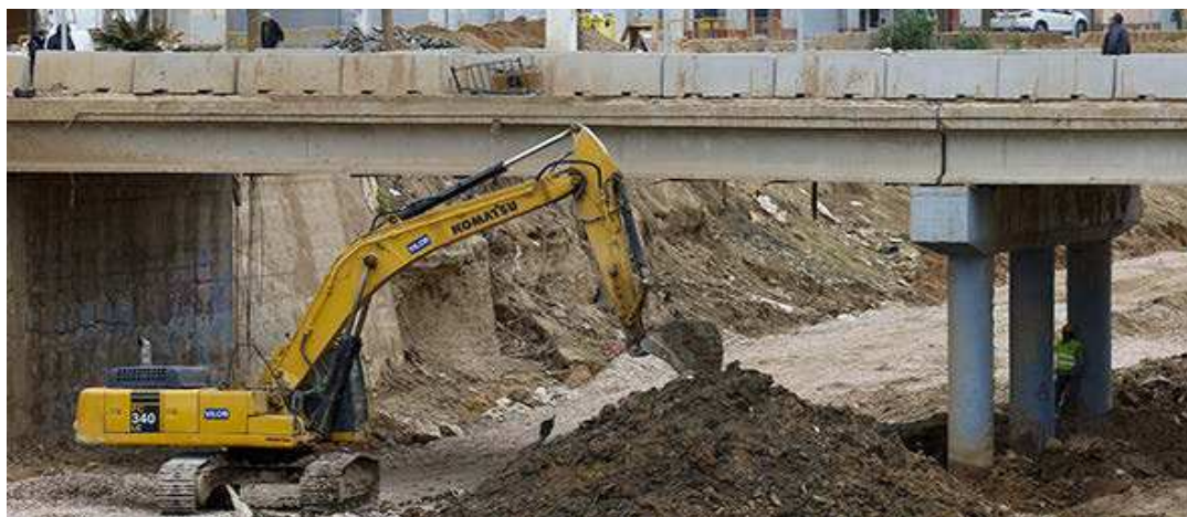
El temporal provocó el derrumbe de varios puentes, especialmente en la zona de la Horta Sud.
