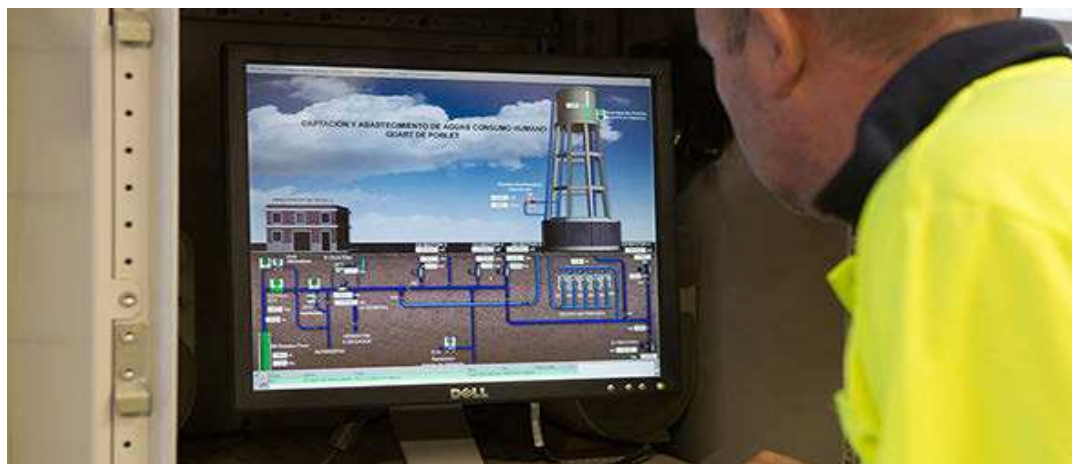
Los sistemas de telecontrol permiten medir y gestionar el agua extraída de pozos y la distribución a través de la red.
