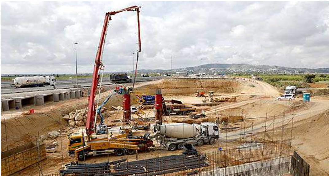
Los municipios de la zona cero llevan meses haciendo frente a las tareas de reconstrucción
