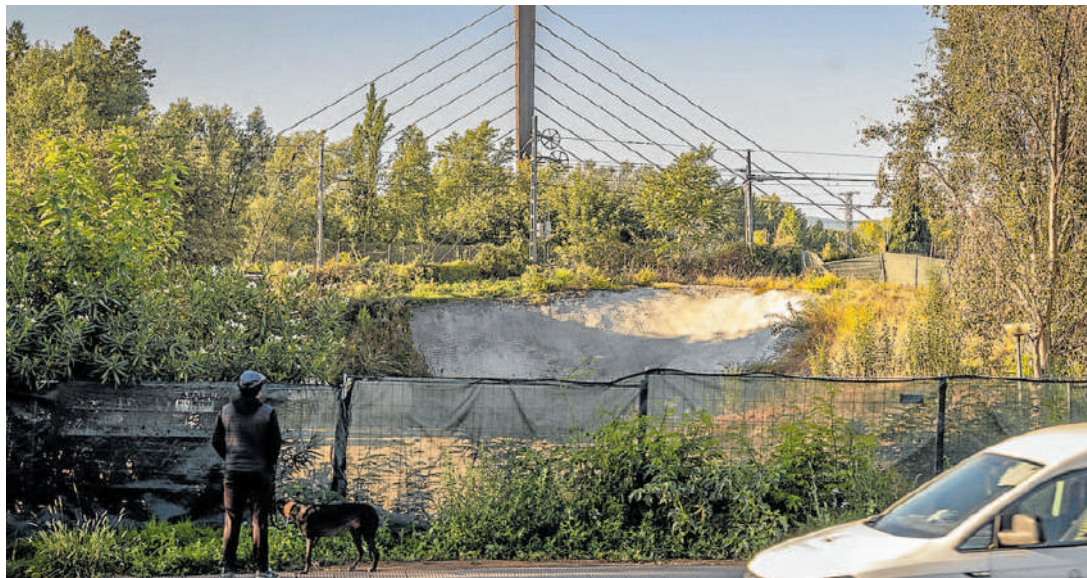
Un ciudadano se asoma para comprobar las suspendidas obras del emisario del Bajo Iregua a la altura del puente de Varea en Logroño. JUSTO RODRÍGUEZ
